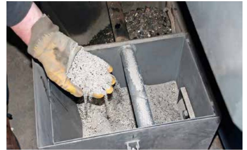
Die neue Heizungsanlage verbrennt die Späne effektiver. Viel bleibt da nicht übrig.
