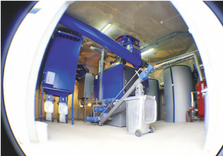
/ Speedmaster verheizt seine Plattenreste mit einer Holzfeuerungsanlage vom Typ USF-W von Endress mit 500 kW. Um die strengen Staubgrenzwerte nach EU-Richtlinien einzuhalten, wurde ein Filter nachgerüstet.
