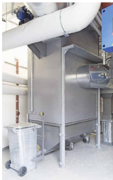
Die Anlage zur vollautomatischen Rauchgasreinigung nach dem Kessel
