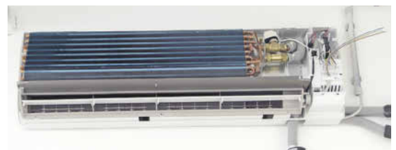
In Serverraum hängt kein Heizkörper, sondern ein Kühlkörper mit Kondenswasserabfluss
