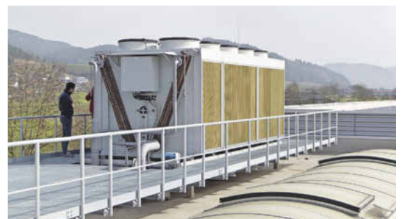
Der Rückkühler des Kältekreislaufs auf dem Dach der Fertigungshalle
