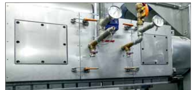
Ein Wärmetauscher holt Restwärme aus dem Abgas.
