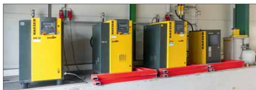
Druckluft-Station für die automatischen Lager im Betrieb: Die Anlage ist so bemessen, dass stets ausreichend Reserven vorhanden sind, denn ohne die Lagertechnik müsste die gesamte Plattenproduktion ruhen.
