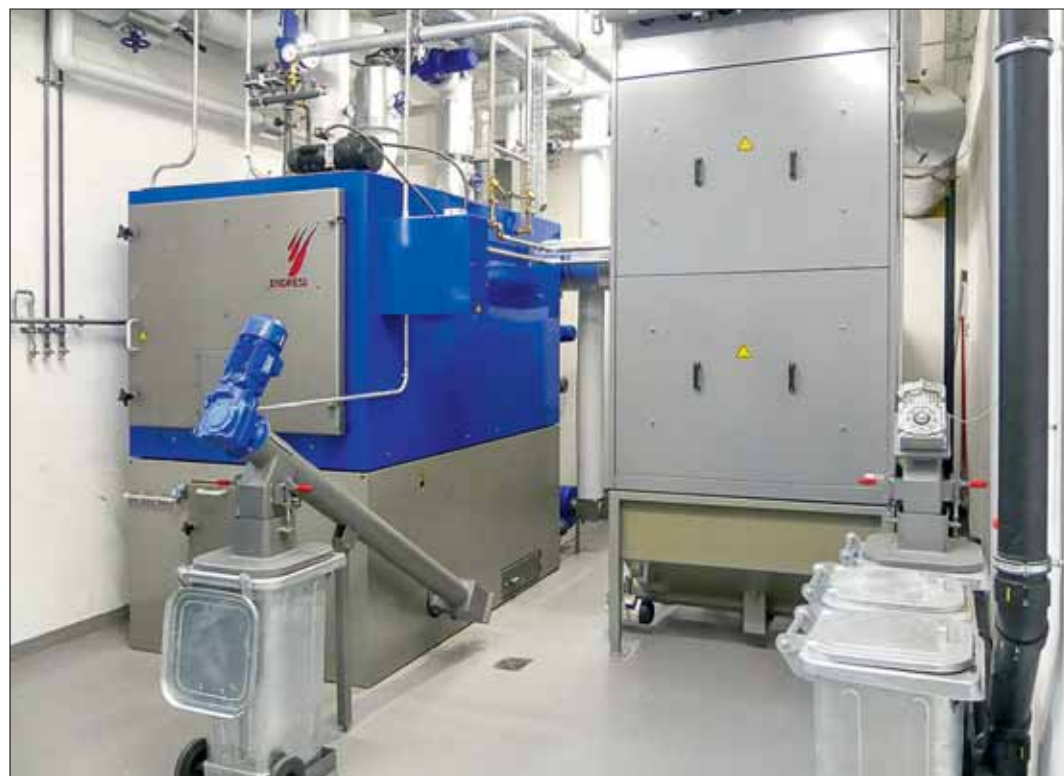
Kessel und Filter (rechts) von Endress sind optimal aufeinander abgestimmt.
