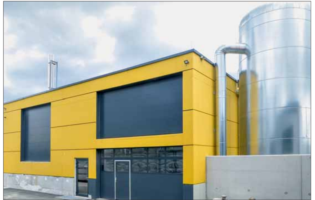
Kesselhaus (noch vor Abschluss der Malerarbeiten) und Pufferspeicher
