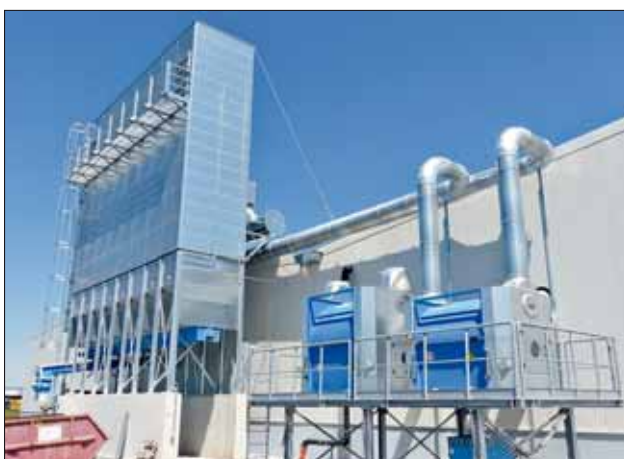
Für die Absaugung in der Fertigung sorgt eine Reihenfilteranlage „NSJ 9/5/48“ von Nestro. Anfallende Stäube werden brikkettiert oder in Big Bags gesammelt.
