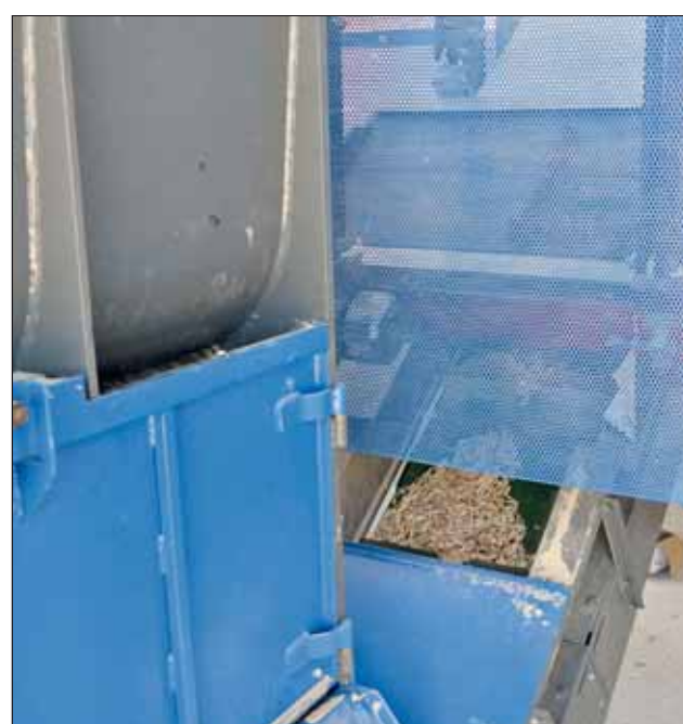
Über dem Förderband zum Brennstoffbunker ist ein leistungsfähiger Band-Magnetabscheider installiert.
