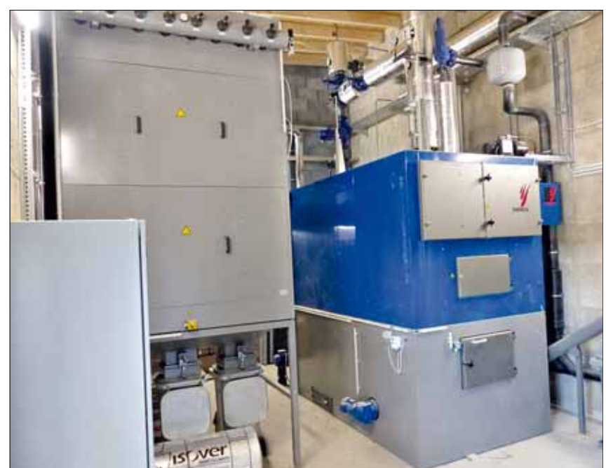
Endress lieferte u.a. die Unterschubfeuerung mit 800 kW und das Gewebefiltersystem (links). Fotos: Weiss (4), Ißleib
