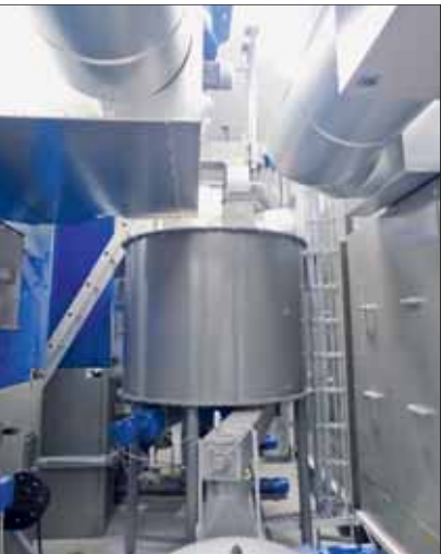
Die oberhalb der Kessel gelagerten Späne werden zunächst in einen Zwischenbehälter gefördert, der die beiden Kessel versorgt.
