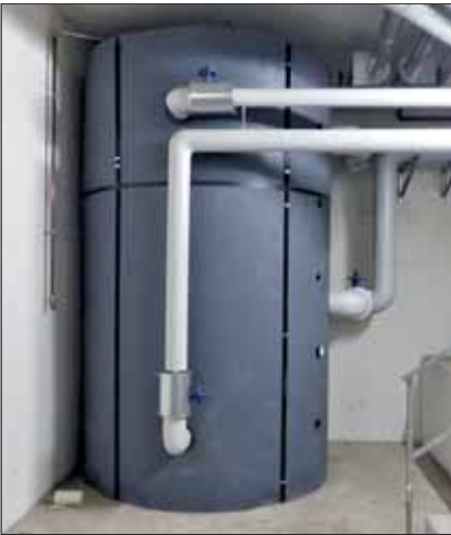
Zur Speicherung wurde ein 10 m³ fassender Zwischenpuffer installiert.
