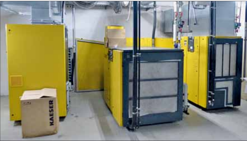
Die Abwärme der Schrauben-Kompressoren wird über Wärmetauscher nutzbar gemacht (hier noch während der Installation).
