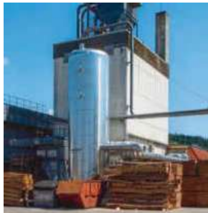
Der 70 000-Liter-Pufferspeicher steht draußen vor dem Späneturm
