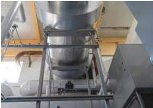
Der Abgaswärmetauscher erwärmt den Heizungsrücklauf mit der Restwärme der Rauchgase
