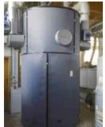
Der 6000-Liter-Speicher steht in der Produktionshalle
