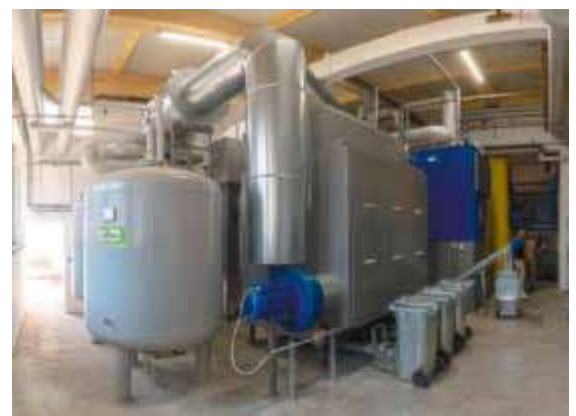
Links die Ausdehnungsgefäße, dahinter der Rauchgasfilter und der Biomassekessel
