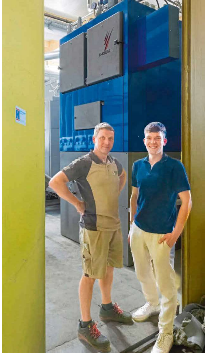
Riesig – und im Vergleich zum Vorgänger dennoch ein Zwerg: Fendts neuer Heizkessel. Davor: Markus Schmid (links) und Jonathan Heese von Endress
