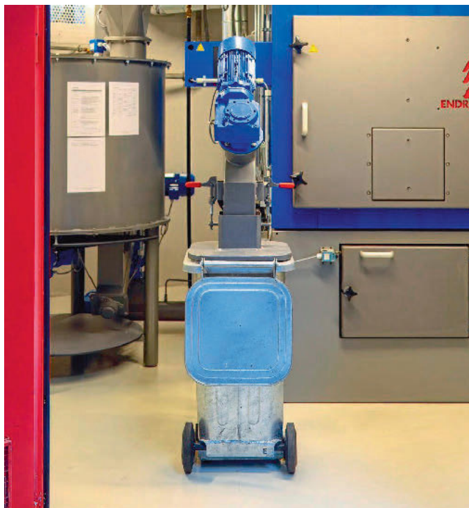
Der Kessel entascht sich automatisch. Diese Tonne ist ebenso wie die der Rauchgasreinigung nur alle paar Wochen zu leeren
