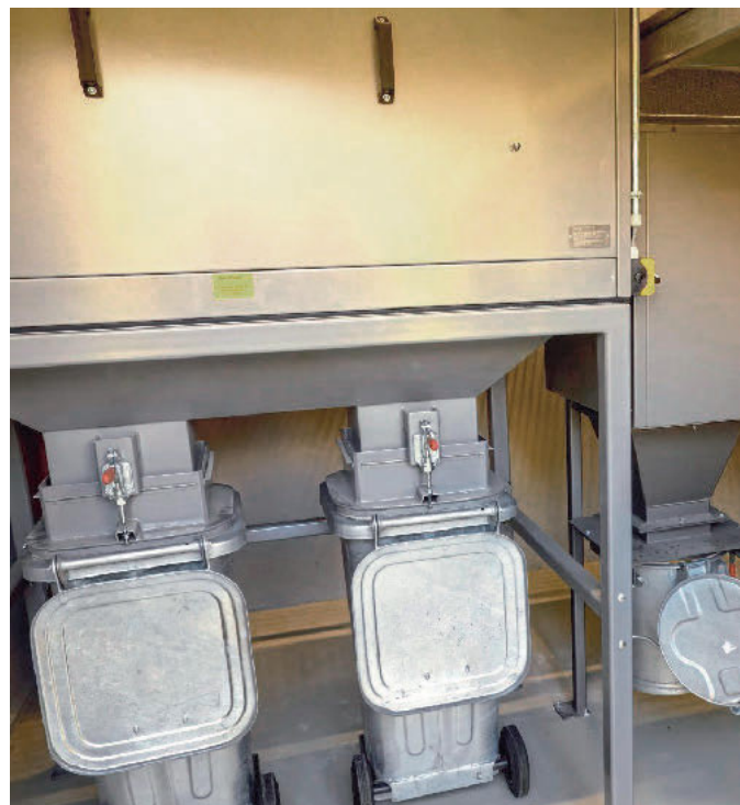
Rauchgasreinigung: Rechts fällt zunächst das Grobe in die Tonne, links der herausgefilterte Staub
