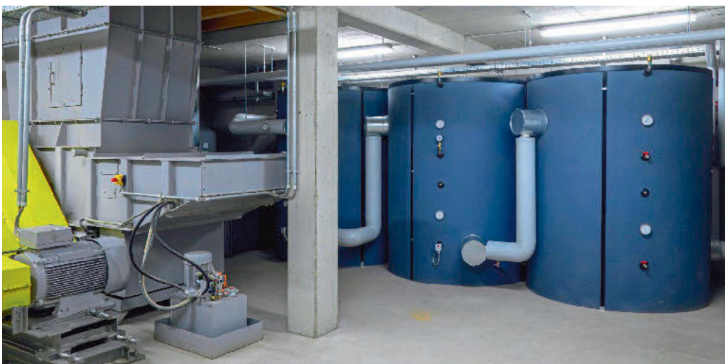
Unter dem Kesselhaus stehen der Hacker und drei Wärmespeicher mit insgesamt 1200 l etwa 80^\circ\text{C} heißen Wassers, die dafür sorgen, dass sich die Feuerung nur selten an- und ausschalten muss
