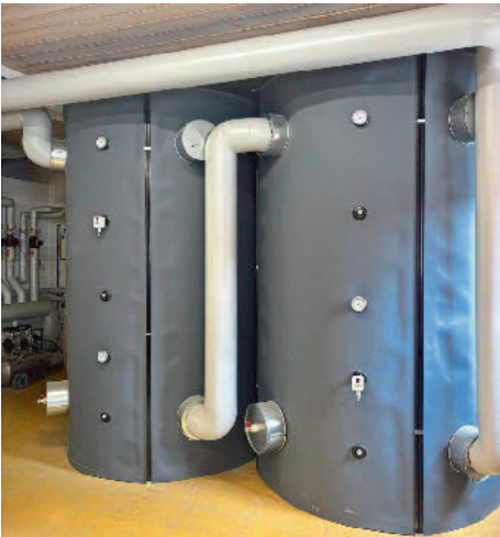
/ Ein Pufferspeicher mit hydraulischem Abgleich sorgt für eine effiziente und gleichmäßige Wärmeversorgung.
