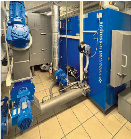
/ Die neue USF-S 210-Heizanlage von Endress versorgt beide Werke und die Wohnhäuser mit Wärme.
