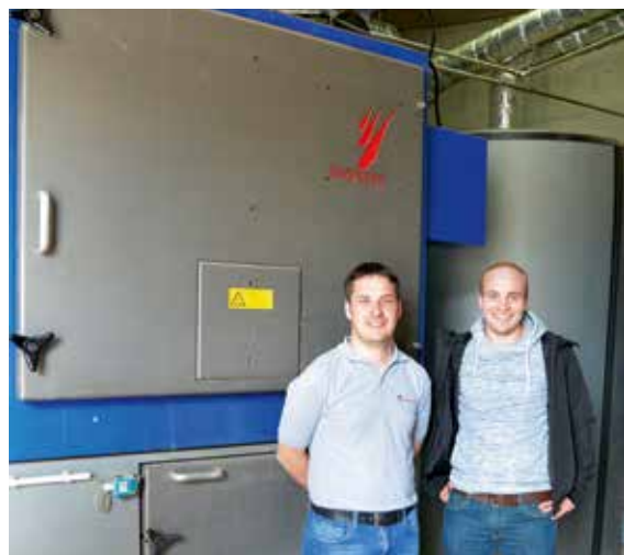
Zufriedene Gesichter vor dem 500 kW-Heizkessel: Speedmaster-Produktionsleiter Christian Leidenberger und Endress-Marketingbeauftragter Andreas Hamberger (v. li.)
